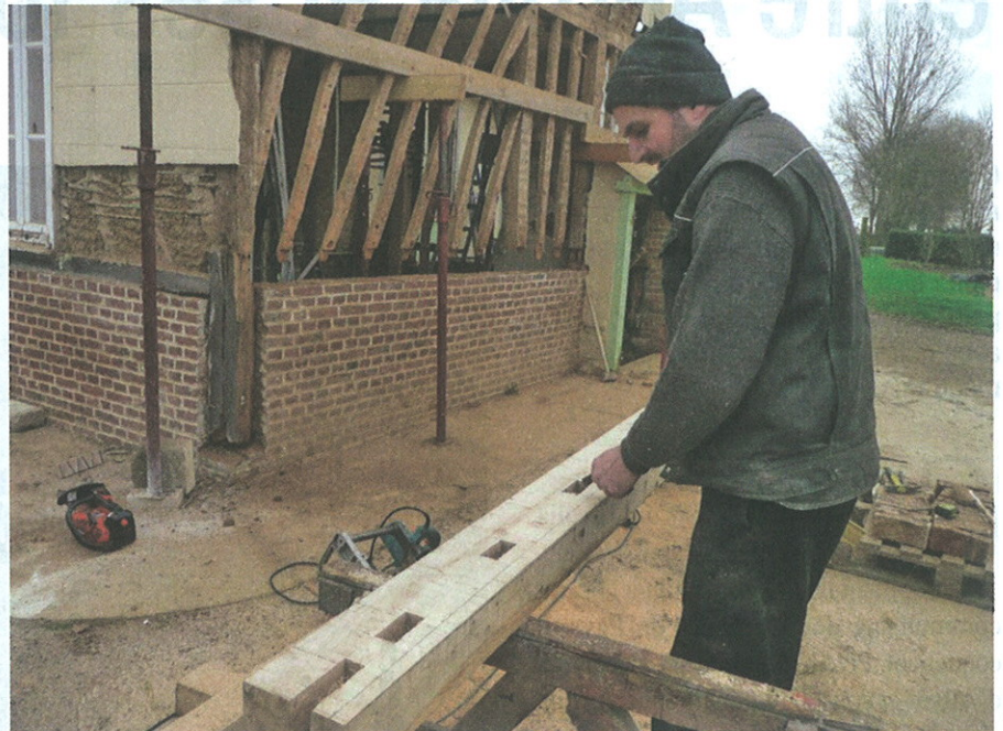
Le ciment avait abîmé la façade en bois de la maison.
